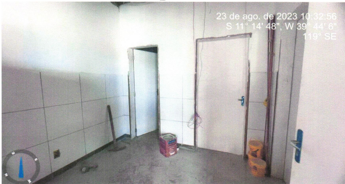
Foto 02 – KIT DE PORTA-PRONTA DE MADEIRA EM ACABAMENTO MELAMÍNICO BRANCO, FOLHA LEVE OU MÉDIA, 90X210, EXCLUSIVE FECHADURA, FIXAÇÃO COM PREENCHIMENTO TOTAL DE ESPUMA EXPANSIVA - FORNECIMENTO E INSTALAÇÃO. AF_12/2019
