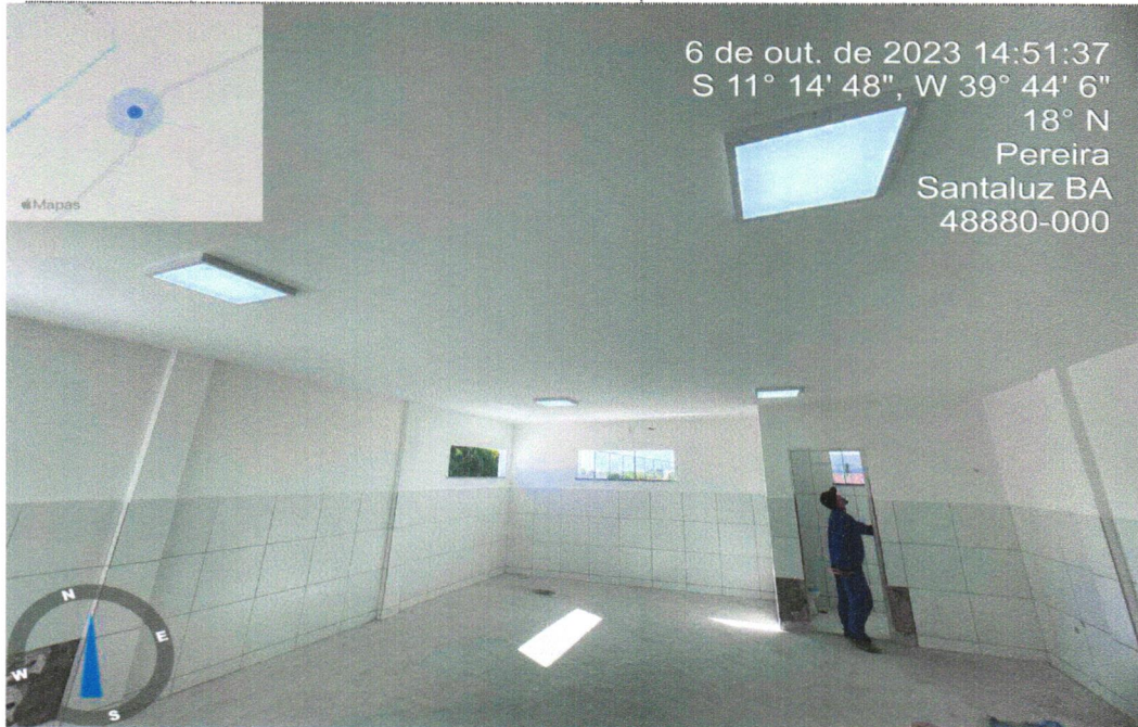
Foto 23 – LUMINÁRIA LED 20W.
