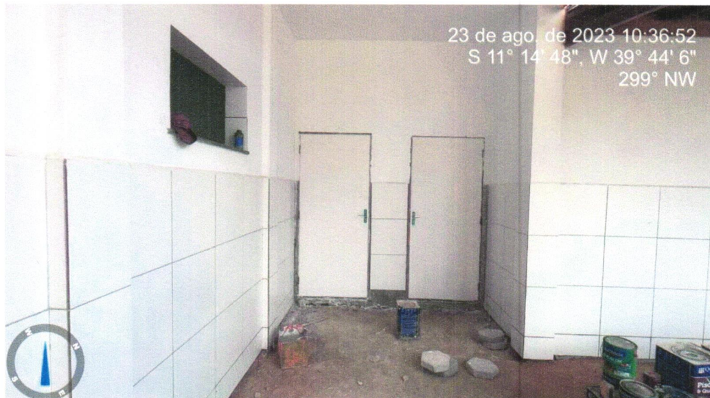
Foto 04 - KIT DE PORTA-PRONTA DE MADEIRA EM ACABAMENTO MELAMÍNICO BRANCO, FOLHA LEVE OU MÉDIA, 80X210CM, EXCLUSIVE FECHADURA, FIXAÇÃO COM PREENCHIMENTO PARCIAL DE ESPUMA EXPANSIVA - FORNECIMENTO E INSTALAÇÃO. AF_12/2019
