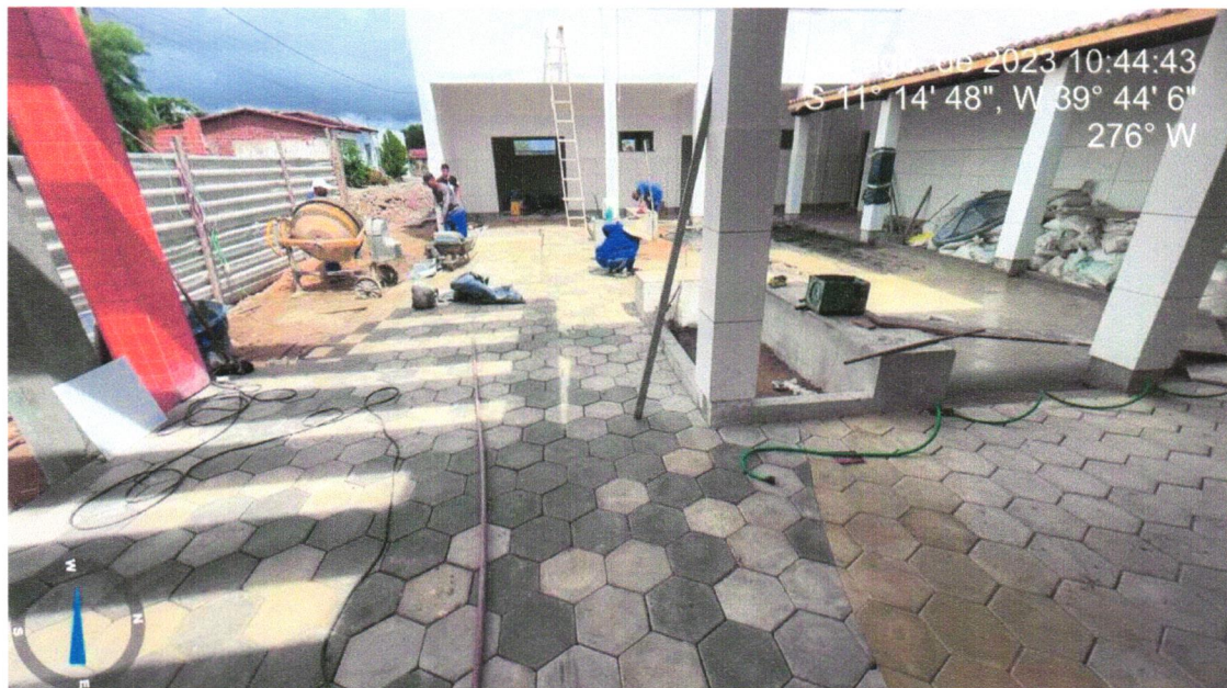
Foto 14 - EXECUÇÃO DE PAVIMENTO EM PISO INTERTRAVADO, COM BLOCO SEXTAVADO DE 25 X 25 CM, ESPESSURA 6 CM.(LARANJA, AMARELO, GRAFITE, NATURA) AF_12/2015
